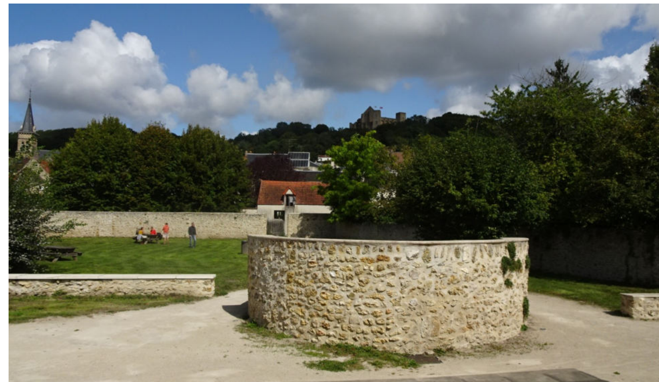
Etat de la muraille après les travaux liés à la création d'un « parvis » devant la maison des associations
